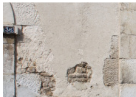
Enduit plein dégradé : des traces d'enduit souvent préservées dans les zones protégées sous la corniche par exemple indiquent le type d'enduit d'origine
