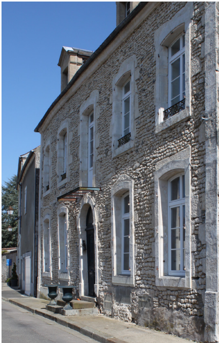
Façade dont l'enduit a été retiré. Les encadrements de baie et les chaînes d'angle débordent par rapport au mur.
