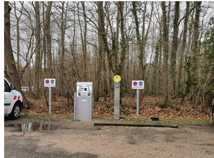
Bornes de recharge électriques à Gouffern en Auge
